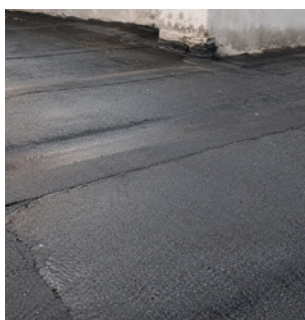
VECCHIE GUAINE BITUMINOSE Contattare l'assistenza tecnica.
