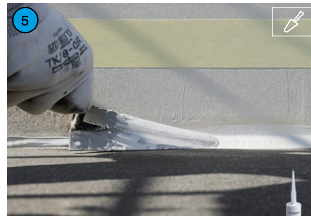
5 Sigillatura dei giunti perimetrali: guaina continua con BETONSEAL MS 2.0 e A FRESCO applicazione di Betonguaina (fig. 6).
